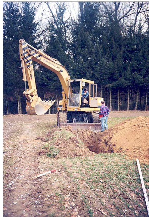
Baggerschlitzsondierungen. Der Geologe U. Schindler gibt dem Maschinenführer Anweisungen. Der Eingang zur Erzhöhle befindet sich im Tannenwald dahinter.
